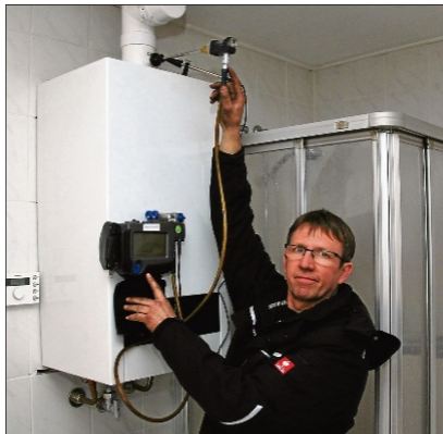
Öl- und Gasheizungen müssen regelmäßig gereinigt werden.
